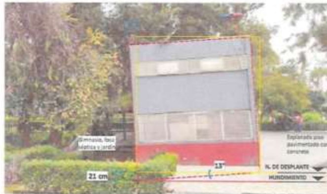
Imagen 11. Fachada lateral (Sur). Se observa desplome del cuerpo 1. (las líneas rojas delimitan el área del inmueble actual y en color amarillo la vertical original), se indican los niveles, colindancias y grados de inclinación.
